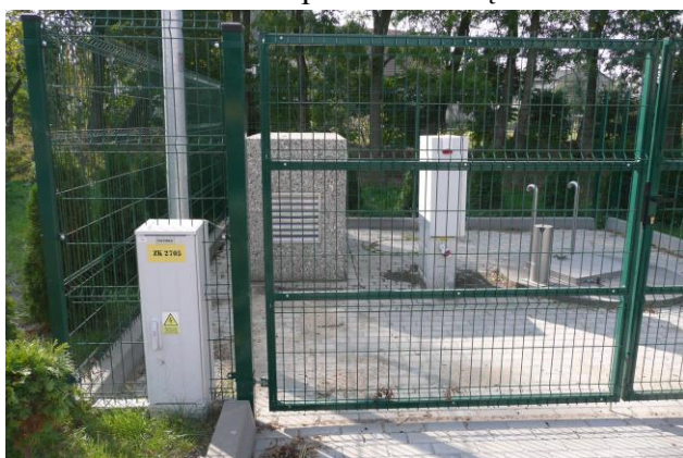
Przepompownia w Gielczycach
