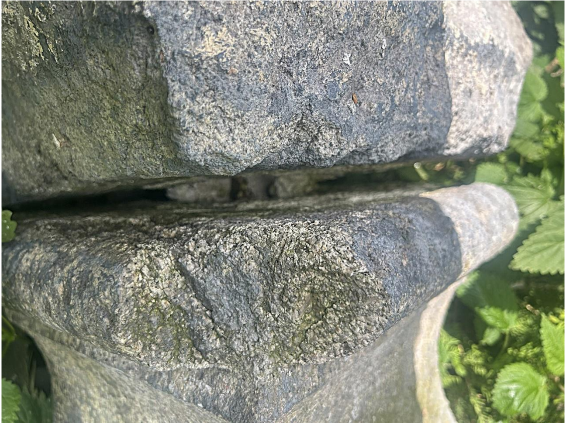
Brak wypełnienia zaprawą pomiędzy kamieniami
