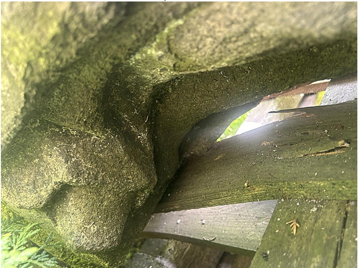
Widoczne złuszczenie powierzchni kamienia
