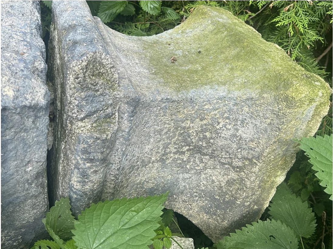
Cokół obiektu- widoczne porażenie mikroorganizmami
