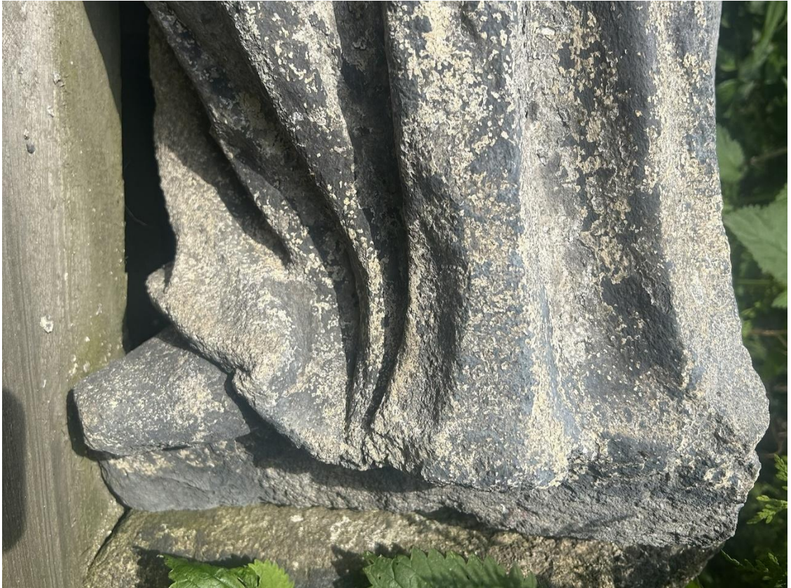
Widoczna osłabiona struktura kamienia w dolnej części sutanny
