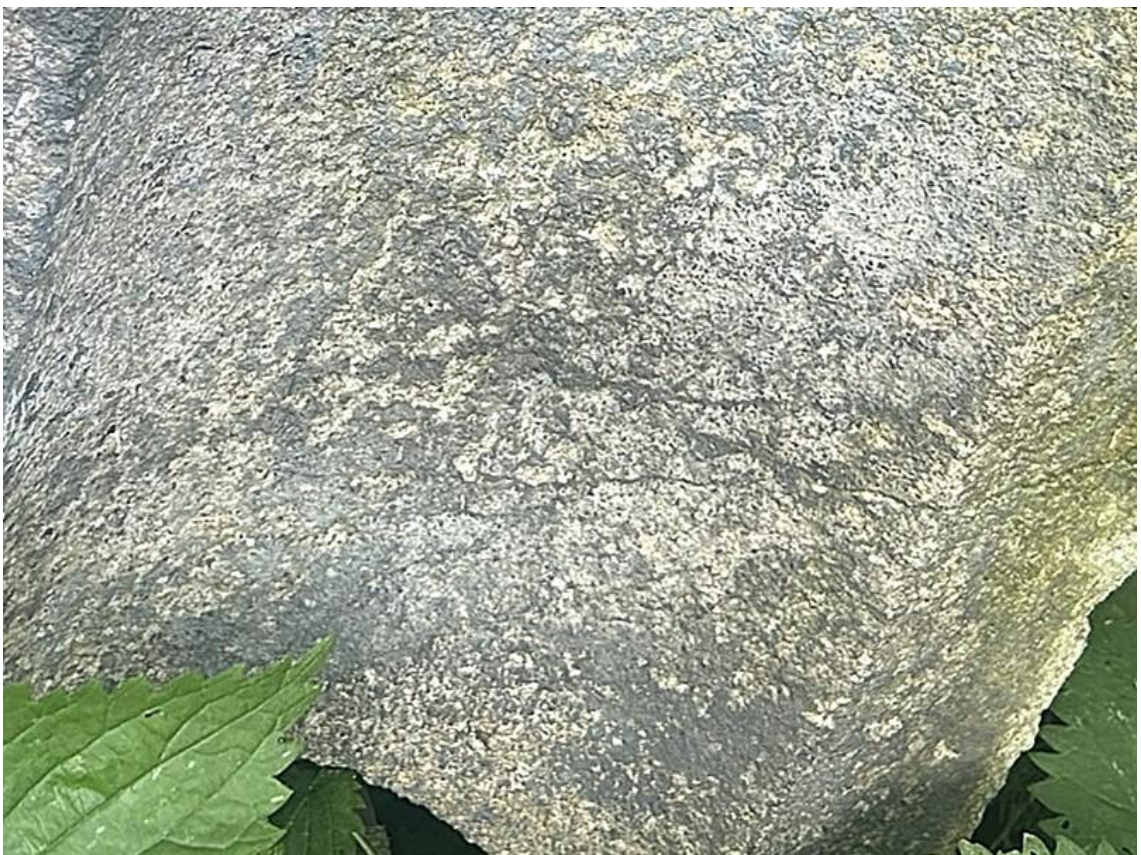
Widoczne pęknięcia szczelinowe postumentu
