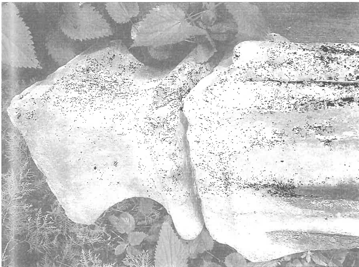
Widoczne nawarstwienia i drobne ubytki
