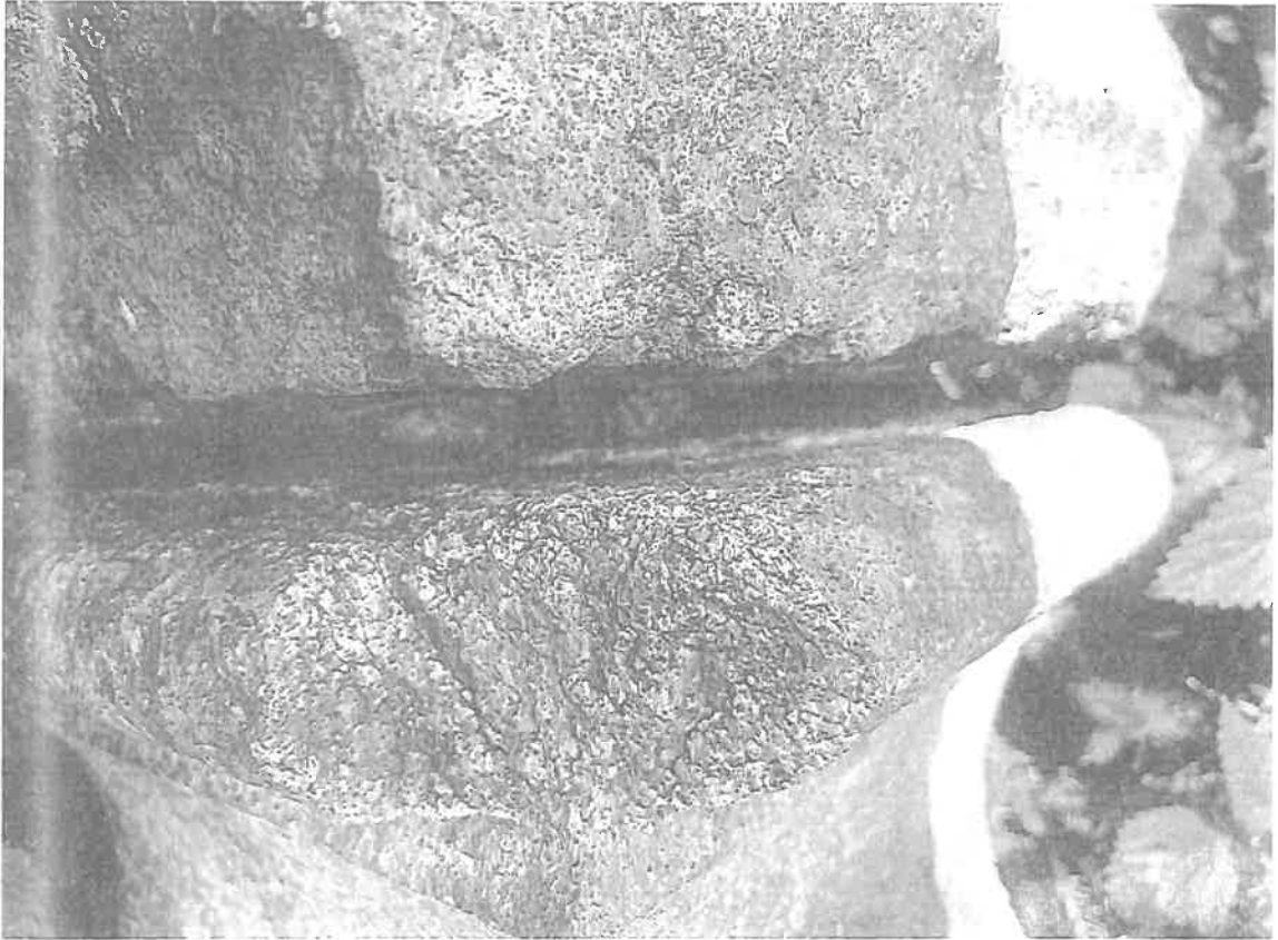
Brak wypełnienia zaprawą pomiędzy kamieniami
